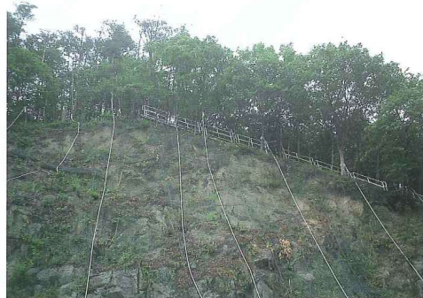
親網点検用としての昇降設備
