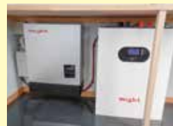
蓄電ユニット
