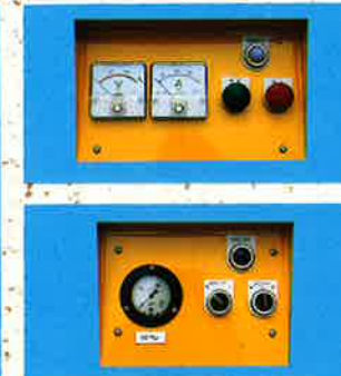
5. 操作盤(操作部)
