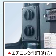
▲エアコン吹出口(前方)
