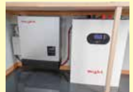
蓄電ユニット
