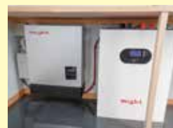
蓄電ユニット
