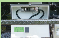
バッテリー切り替えスイッチ
