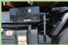
非常用手動ポンプ&amp;非常用操作バルブ
